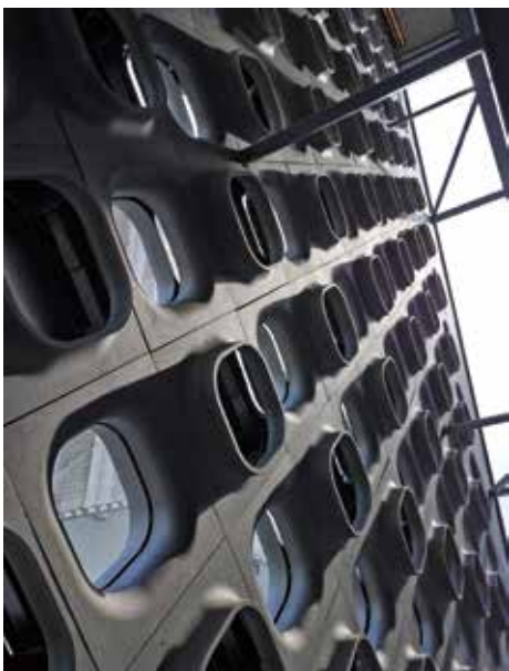
教學大樓鑄鋁漏窗局部
